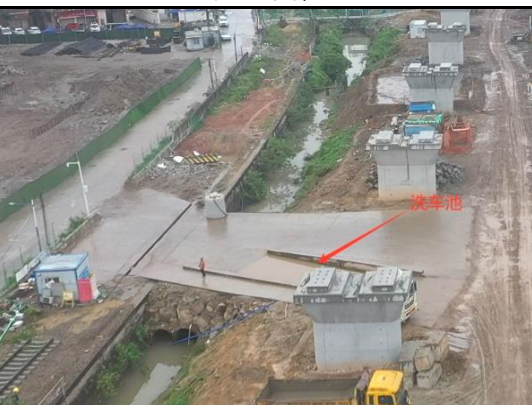
车辆冲洗设施
