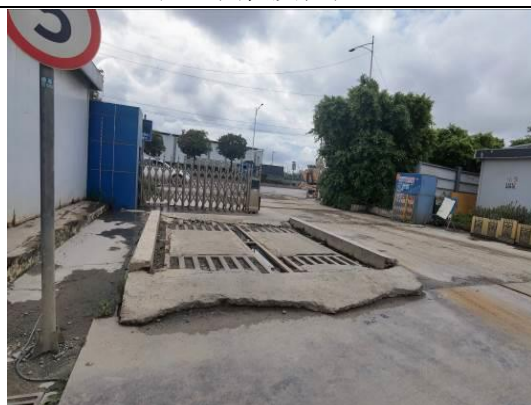
车辆冲洗设施
