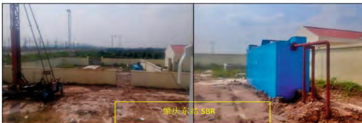
2-肇庆东站（既有污水处理设施）
