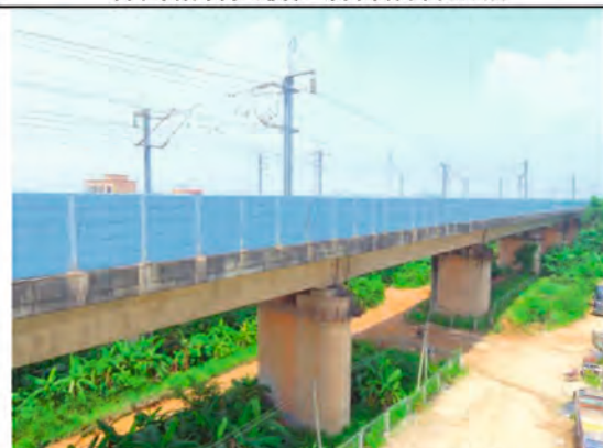
正社 1 号大桥声屏障病害整治
