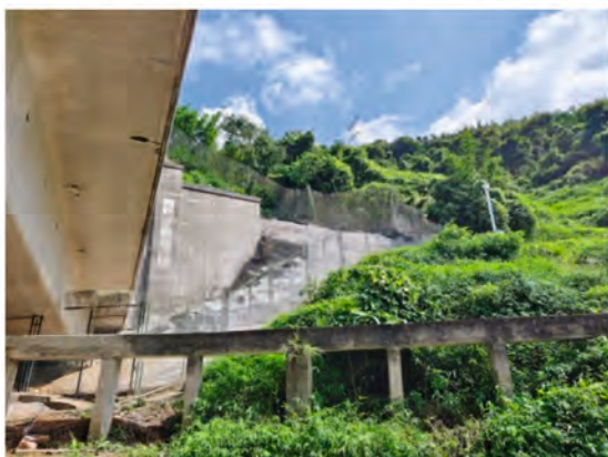
K766+950 上兴隧道出口崩塌落石处理
