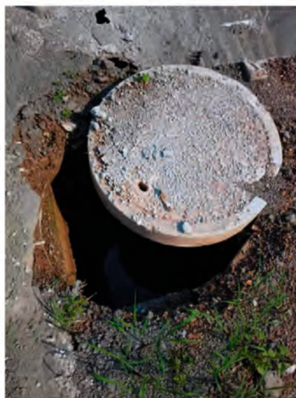
肇庆东生活区化粪池
