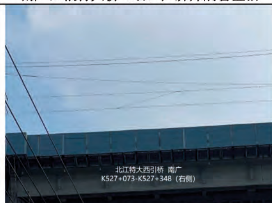
北江特大桥西引桥（右）声屏障病害整治
